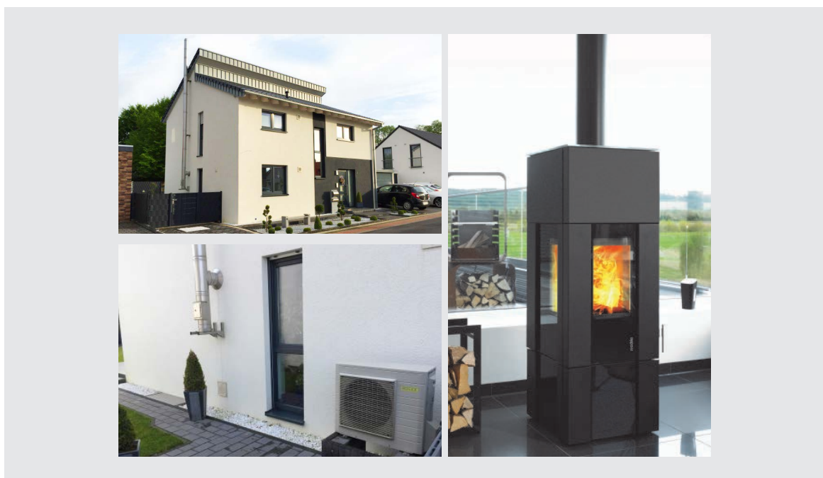
Abb. 8: Beispiel 1 – Luft-Wasser- Wärmepumpe und raumluft- unabhängiger Kaminofen mit einer Abgas- anlage aus Edelstahl an der Fassade
